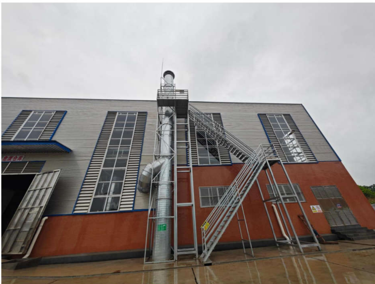
图 10.5-1 DA013 排气筒采样口及采样监测平台
