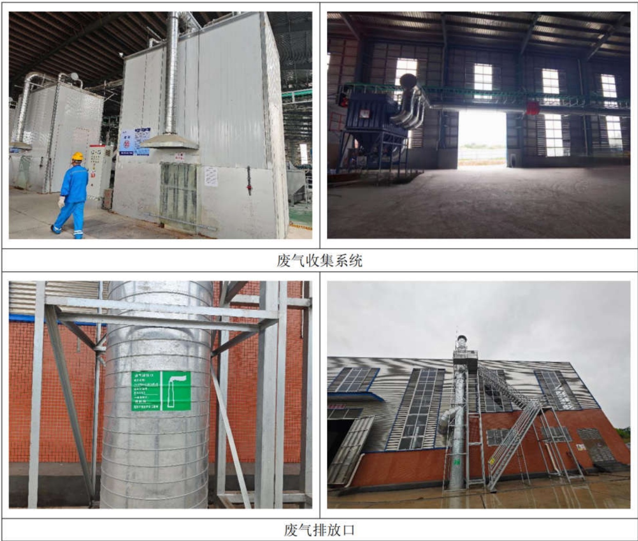
图 4.2-1 项目废气治理设施现场照片
