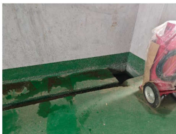
废树脂粉仓库截污沟和集液池
